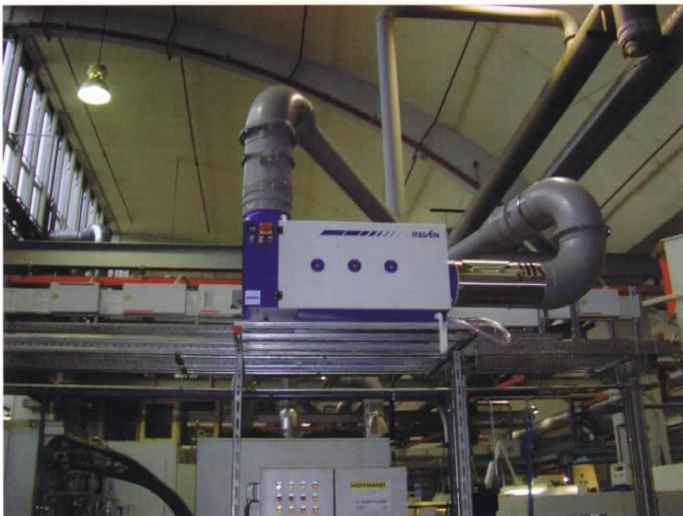
Bild 1: Ein Ölnebelabscheider im LKW-Werk von MAN München. Er hält den langen Abluftkanal sauber und ist flammendurchschlagsfest (Werkbilder: Rentschler Reven, Sersheim)
